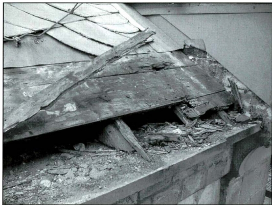
Schäden am Dach
