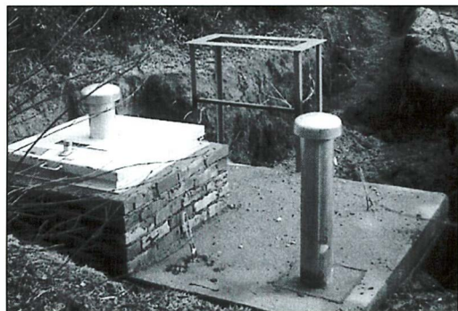
Kontrollschacht für Wasser
