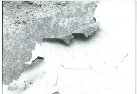
Schadensbild der Latexbeschichtung
