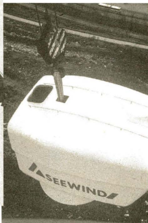
5) Die Gondel (Maschinenhaus) ist mit über 30 Tonnen das schwerste Teil der Windmühle
